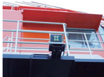
クレーン部LED作業用照明
